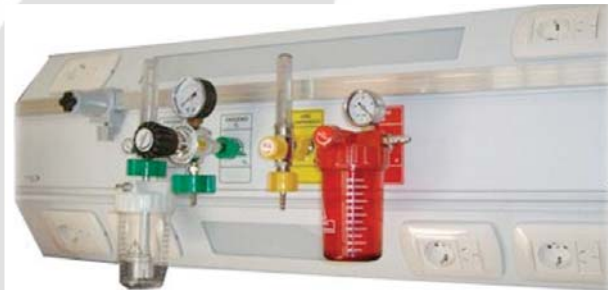
Fig. 9. Torre de iluminación con toma de oxígeno.
